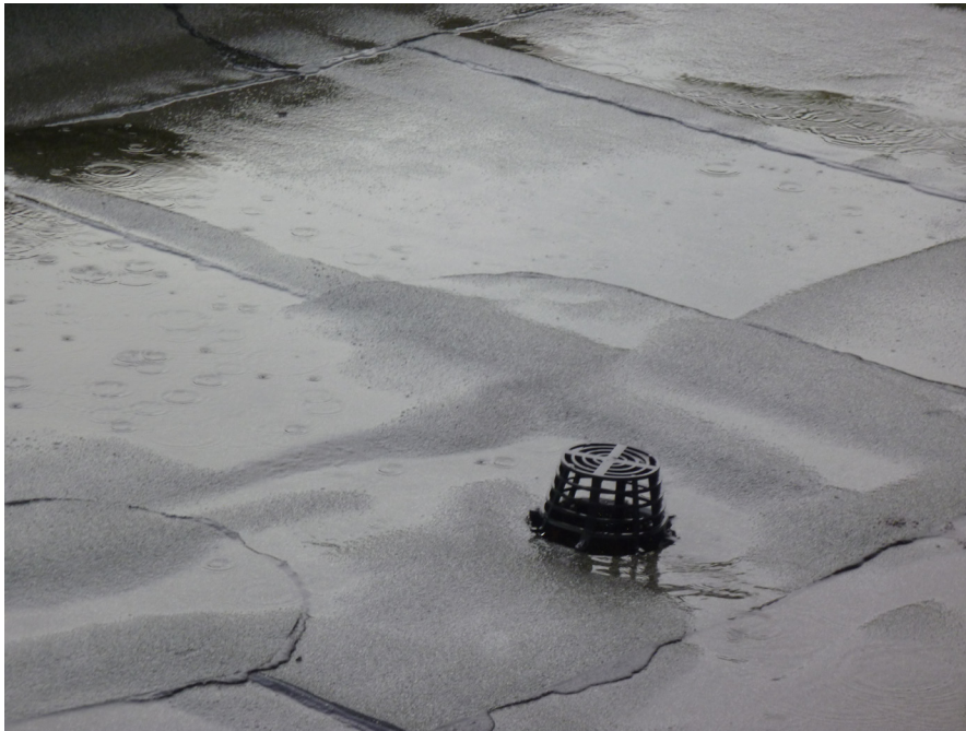
Zu hoch eingebauter Dachgully, Flicken und Pfützen auf dem Flachdach
